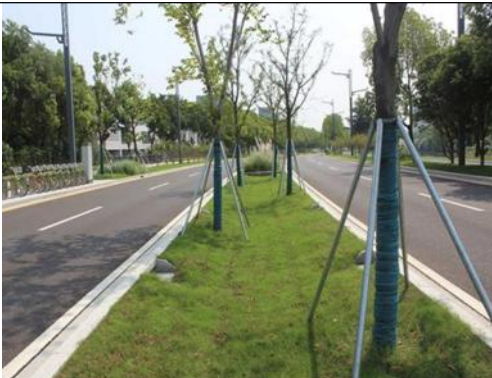
典型问题 1：机非分离绿化带面积小，下凹深度不够，无溢流排放设施，调蓄能力有限。
